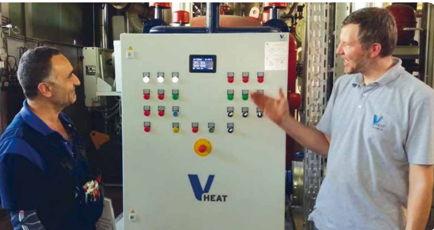
↑ Inbetriebnahme der ersten Generation RS4 im hochsensiblen Bereich einer Heißwasseranlage im Krankenhaus
